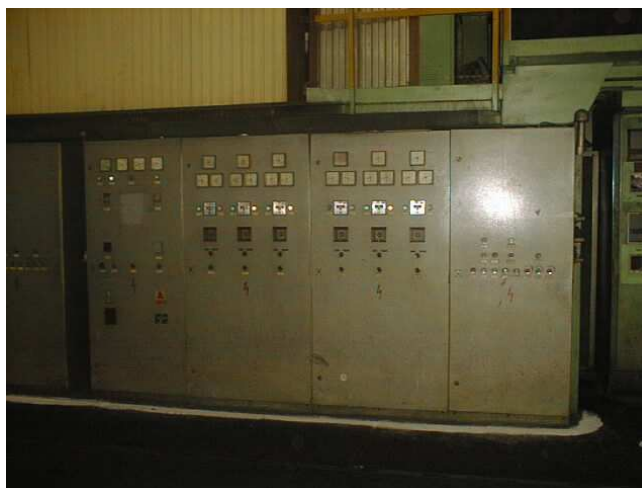
Obrázek 2-2 Pohled na rozvaděč REALISTIC
